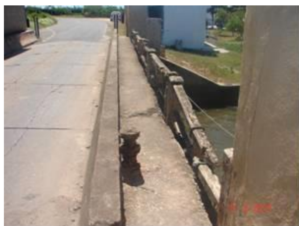
Foto 5.5.2.4 - Guarda-corpo quebrado e trincas no piso da ponte rodoviária oferecendo perigo aos transeuntes. Necessidade de completa recuperação civil, estrutural e mecânica desse sistema de controle de fluxo.
