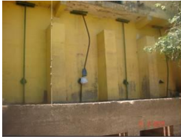
Foto 5.1.2.3 - Vista dos tubos-guias empenados e sem condições de funcionamento. Pode-se visualizar ainda a ausência de mancais. Todo esse conjunto de comportas metálicas necessita ser removido e substituído.
