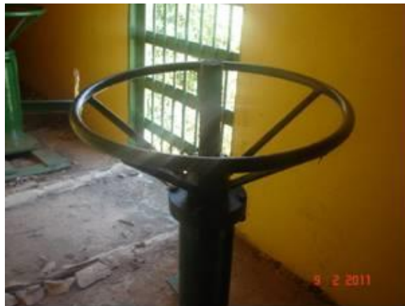
Foto 5.1.2.2 - Vista do sistema de manobra das comportas. Necessidade de substituição de todo o sistema mecânico dessa estrutura.
