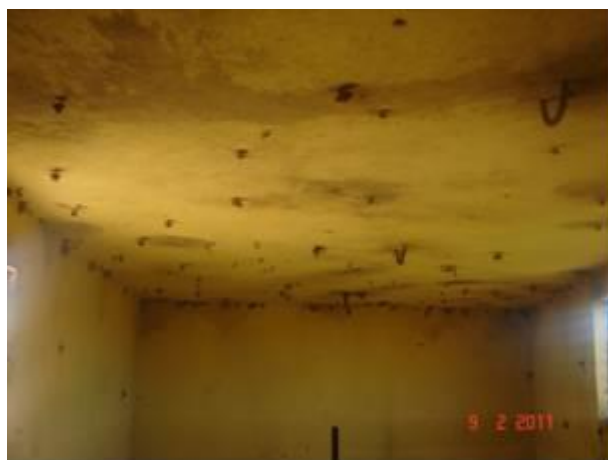
Foto 5.2.2.3 - Vista interna do castelo de proteção das comportas tomado por ninhos de marimbondos e de outros insetos. Necessidade de completa recuperação civil da estrutura.
