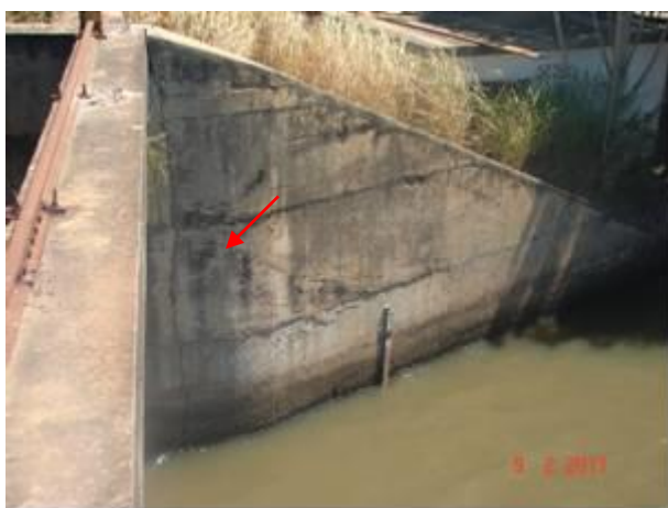
Foto 5.4.2.2 - Vista da rachadura existente na ala de adução (lado direito da barragem), que permite infiltração lateral e comprometimento do aterro sob o acesso à ponte rodoviária. Necessidade de recuperação estrutural.
