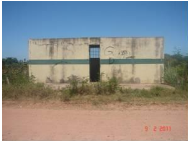
Foto 5.2.2.1 - Vista frontal do castelo de proteção das comportas. Necessidade de completa recuperação civil.
