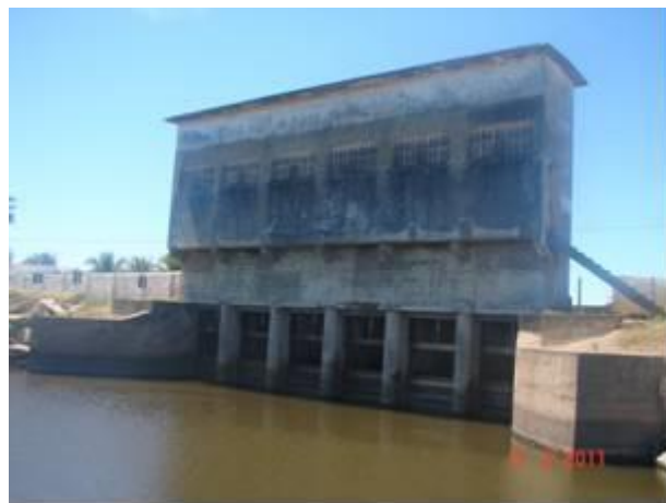
Foto 5.5.2.1 - Vista da estrutura de regulação de fluxo do canal Furadinho e suas seis comportas tipo vagão. Necessidade de completa reforma civil e mecânica da estrutura.
