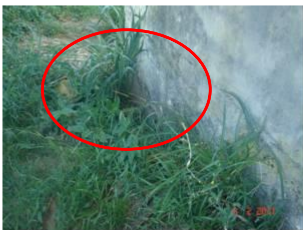
Foto 5.1.3 - Problemas estruturais que geram fuga de material externo para o interior da galeria devido à rachadura existente no concreto da base do castelo e do desgaste das juntas de dilatação.
