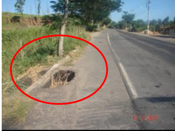
Foto 5.1.4 - Um dos buracos existente no acostamento da rodovia RJ 156 gerado pela fuga de material para o interior da galeria. Problemas estruturais nas juntas de dilatação.
