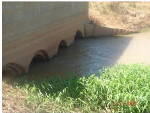
Foto 5.2.2.5 - Vista da ala de condução e suas galerias circulares. Necessidade de instalação de grade apra-lixo.
