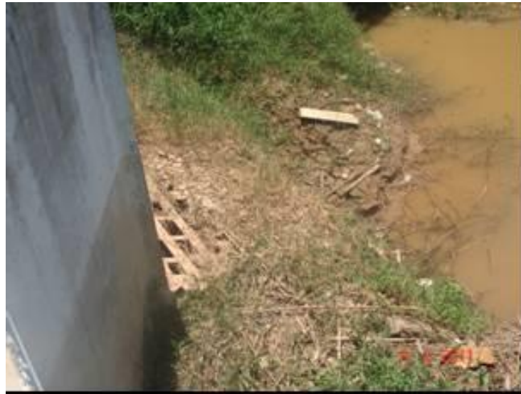
Foto 5.3.2.3 - Grade apara-lixo da tomada d'água da comporta totalmente obstruída. Necessidade de reforma e manutenção periódica.
