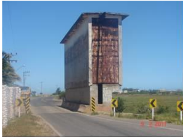
Foto 5.5.2.2 - Vista da situação atual da estrutura, totalmente desgastada pela ação do tempo e pela falta de manutenção.
