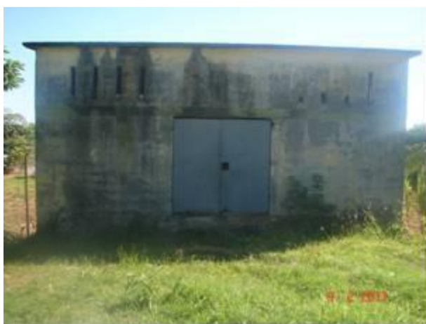
Foto 5.1.2 - Vista frontal do castelo de proteção das comportas em relativo estado de conservação. Necessidade de reforma civil.
