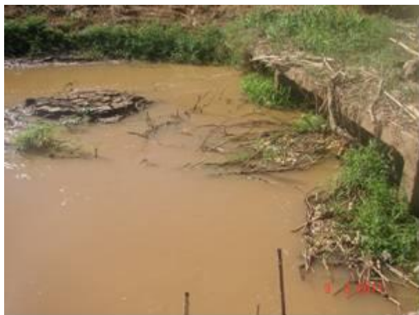
Foto 5.1.1 - Assoreamento existente no canal de aproximação entre o rio Paraíba do Sul e a tomada d'água da comporta e entupimento das grades apra-lixo.
