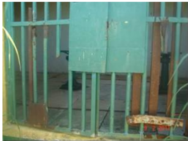
Foto 5.2.2.2 - Portão de fechamento do castelo de proteção das comportas parcialmente danificado.
