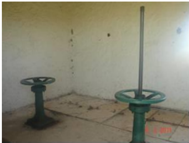
Foto 5.2.2.3 - Pedestais para acionamento e manobras das comportas. Necessidade de recuperação do sistema mecânico.
