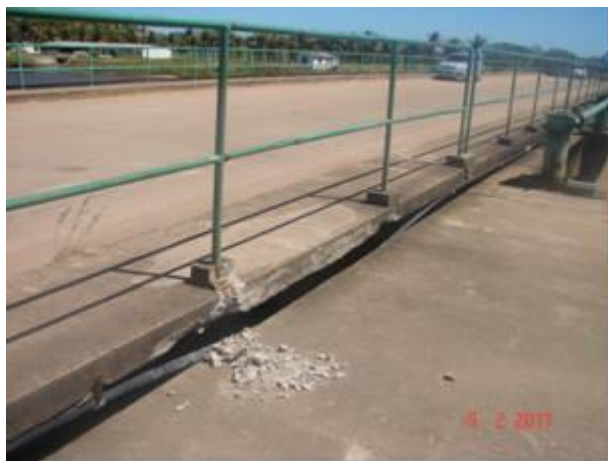
Foto 5.4.2.6 - Desgastes na estrutura. Necessidade de recuperação estrutural
