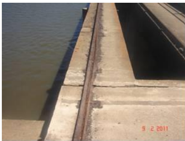
Foto 5.4.2.7 - Desgastes das estruturas de apoio às operações de abertura e fechamento das comportas. Necessidade de completa recuperação civil, estrutural e mecânica de toda a barragem.
