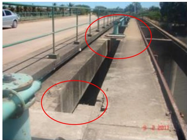
Foto 5.4.2.5 - Ausência de pedestais de manobras das comportas. Necessidade de reforma e modernização de todo o sistema mecânico das comportas.
