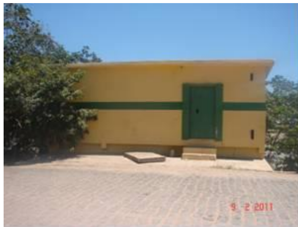
Foto 5.1.2.1 - Vista frontal do castelo de proteção das comportas. Necessidade de recuperação civil.
