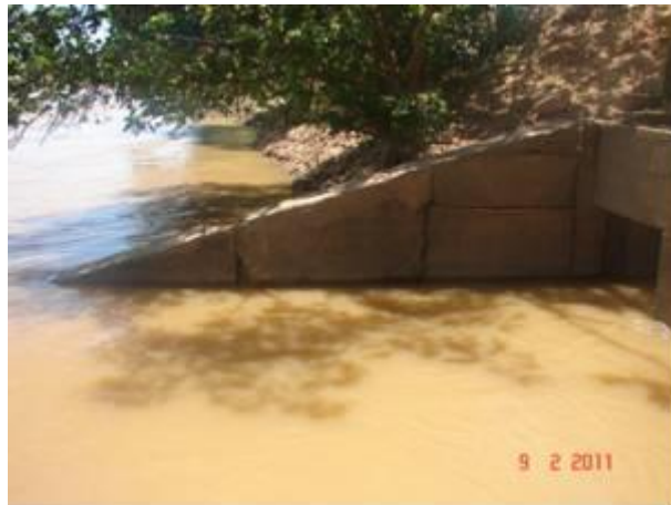
Foto 5.1.2.4 - Vista de uma das guias da ala de adução estruturalmente comprometida. A do lado esquerdo também se encontra na mesma situação. Necessidade de reconstrução.
