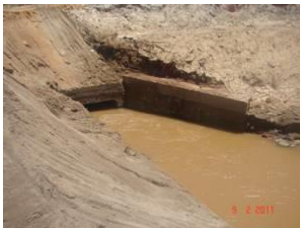
Foto 5.1.2.5 - Vista de uma das guias da ala de condução que se partiu. Necessidade de reconstrução.
