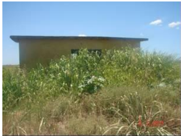
Foto 5.2.2.1 -Vista frontal do castelo de proteção das comportas, em relativo estado de conservação, apesar do excesso de vegetação no entorno. Necessidade de reforma civil.
