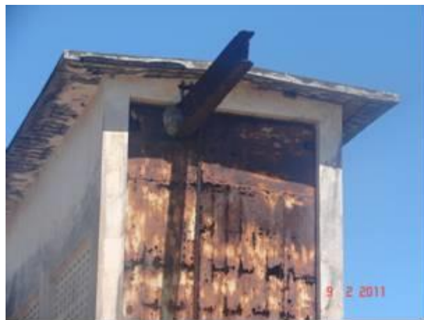
Foto 5.5.2.3 - Vista, em detalhe, da viga de manobra e remoção das comportas e da laje do castelo. Necessidade de completa reforma na estrutura desse castelo de proteção.
