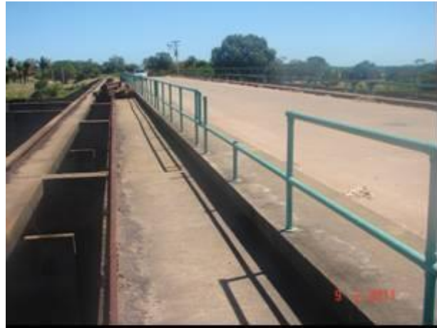
Foto 5.4.2.3 - Vista do guarda-corpo parcialmente destruído..
