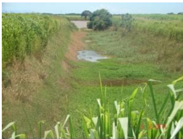
Foto 5.2.2.4 - Assoreamento existente no canal de ligação entre o rio Paraíba do Sul e a tomada d'água.
