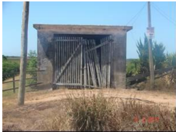
Foto 5.4.2.4 - Situação atual do galpão de apoio à barragem. Bastante destruído devido à ação do tempo e à falta de conservação.
