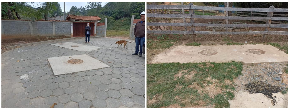
Figura 10 – Estações elevatórias de esgoto já instaladas em Areias, em junho de 2022.
