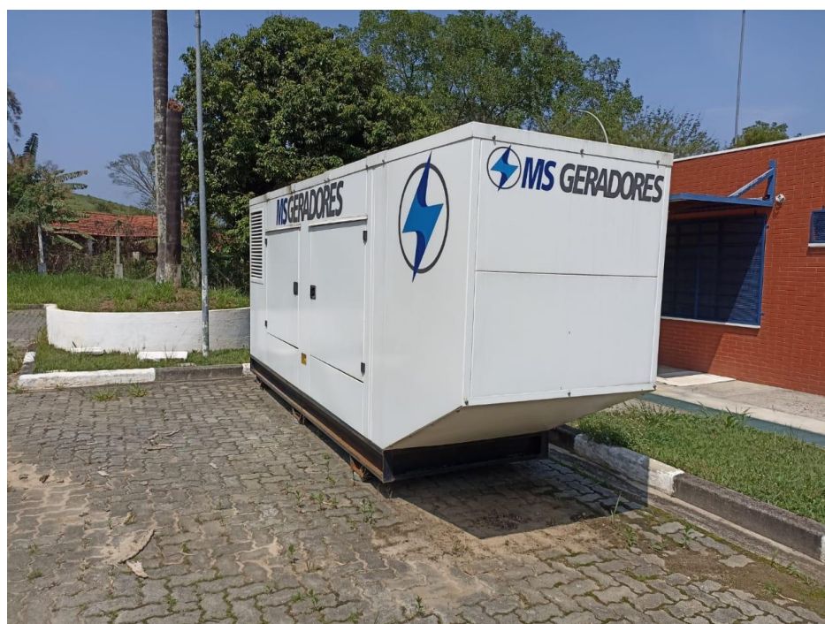
Figura 8 – Imagem do gerador instalado na ETE Bandeira Branca - Jacareí, em outubro de 2022.
